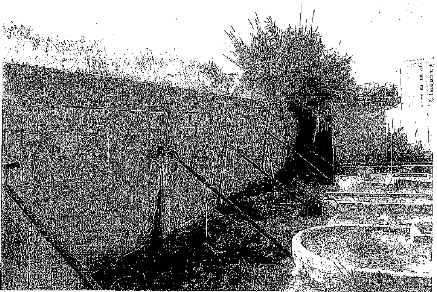
MURO PERIMETRALE A RISCHIO CROLLO
